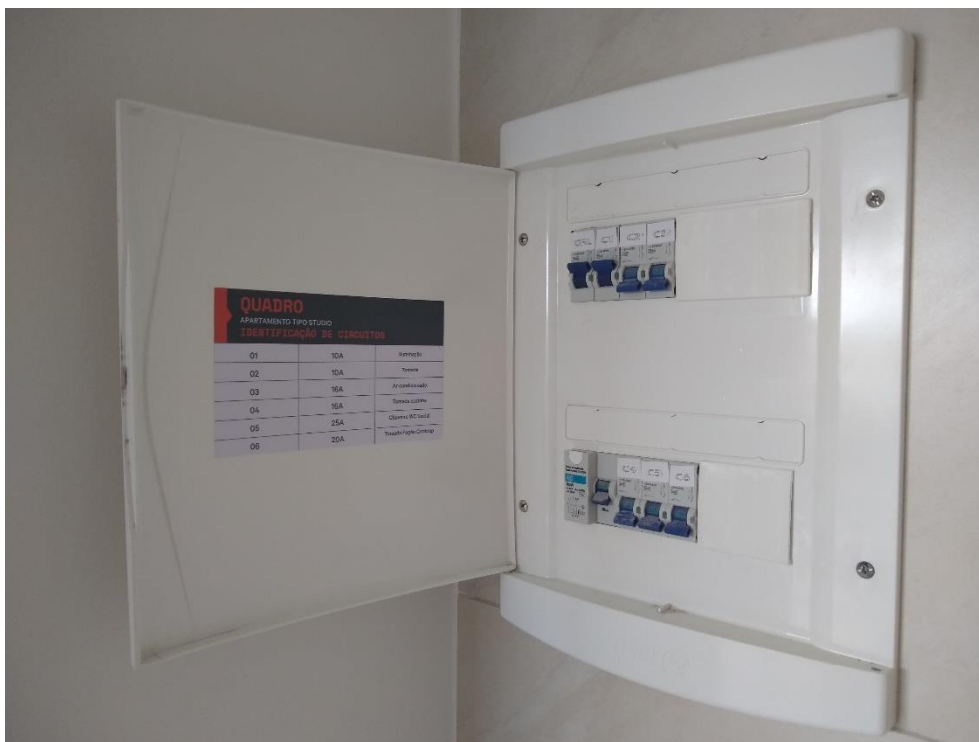
Figura 9 – Quadro de Distribuição – Apartamentos Tipo
