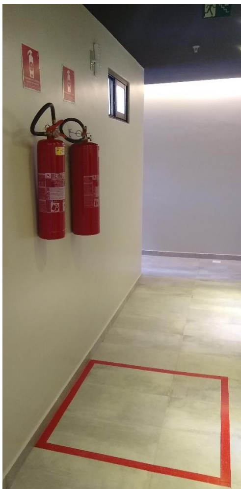
Figura 11 – Extintores dos Halls
