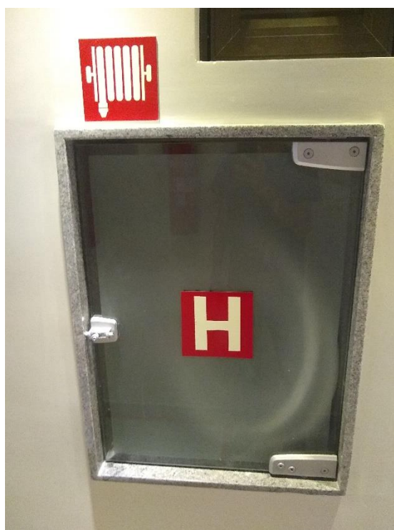
Figura 12 – Caixas de Incêndio
