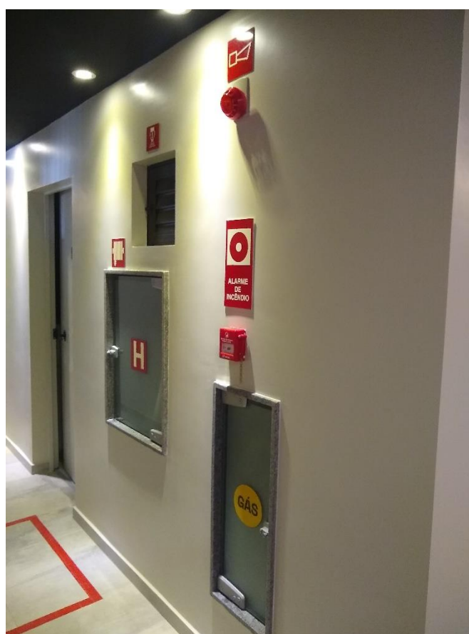
Figura 13 – Equipamentos e sinalização de incêndio
