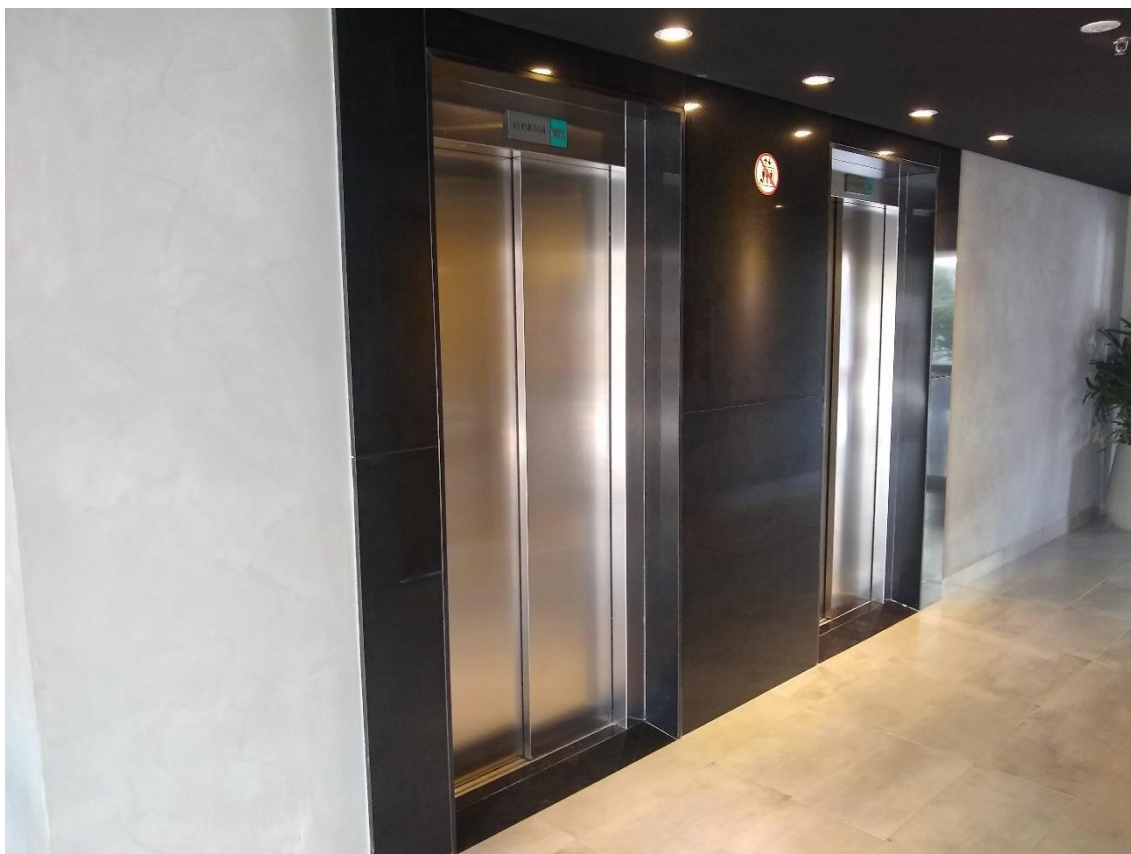
Figura 18 – Elevadores do empreendimento
