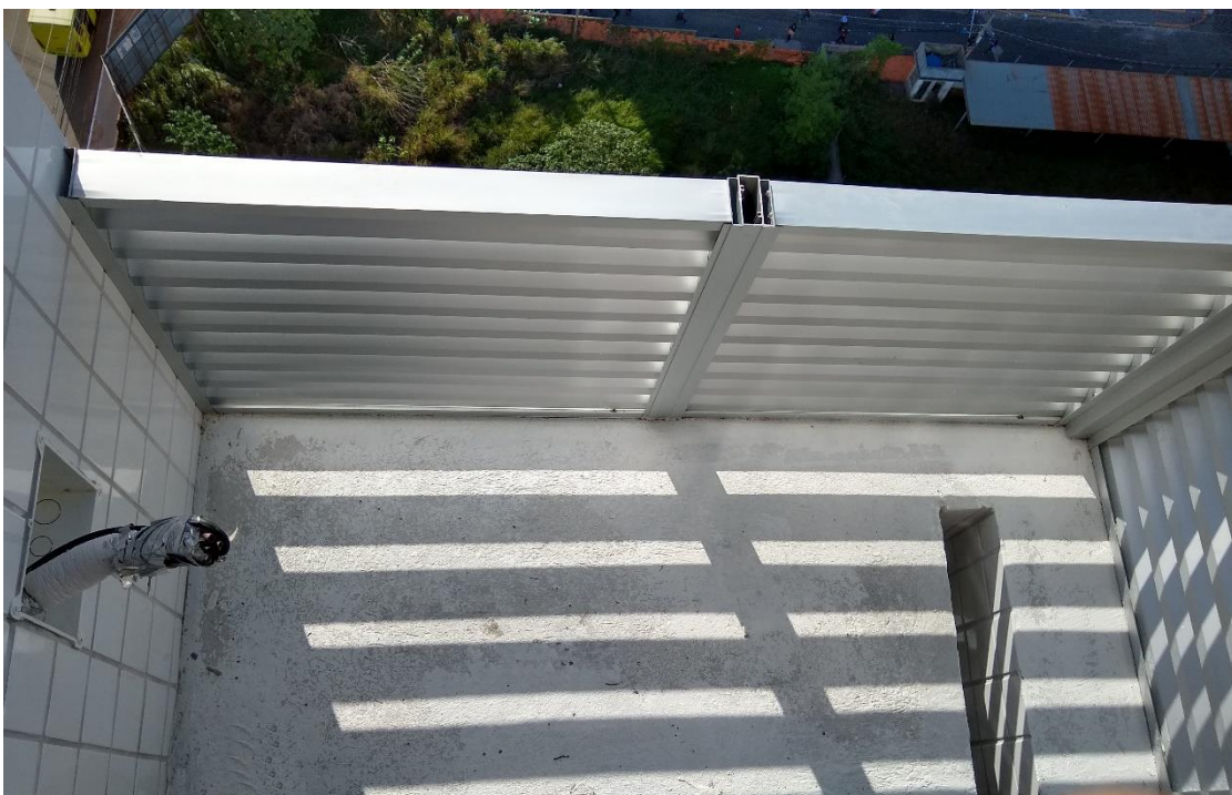
Figura 19 – Área Técnica para instalação do equipamento de ar condicionado
