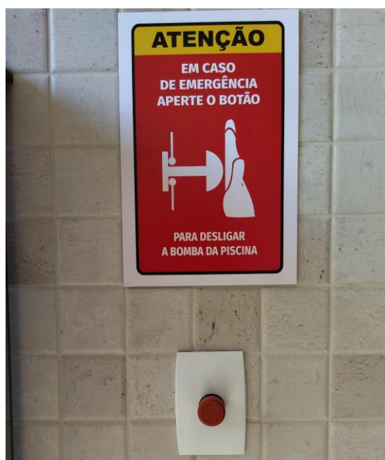
Figura 23 - Botão de emergência da piscina
