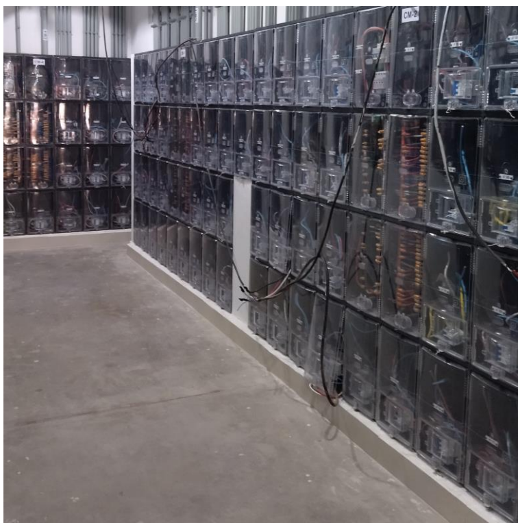
Figura 17 - Centro de medição de energia elétrica
