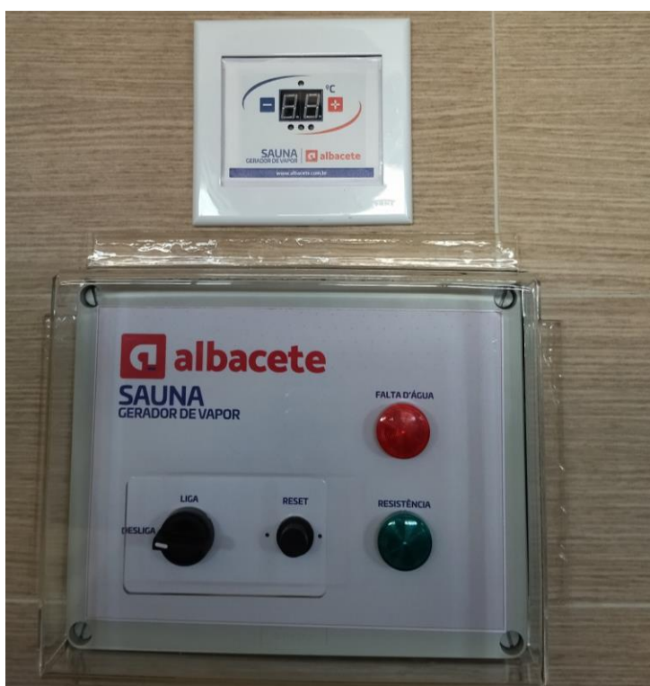
Figura 26 - Equipamento do gerador de vapor elétrico da Sauna
