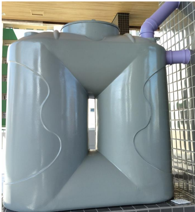
Figura 21 - Tanque de reuso das águas pluviais
