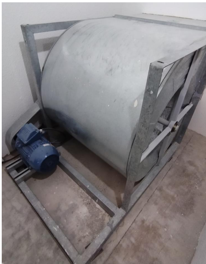
Figura 29 - Ventilador de pressurização
