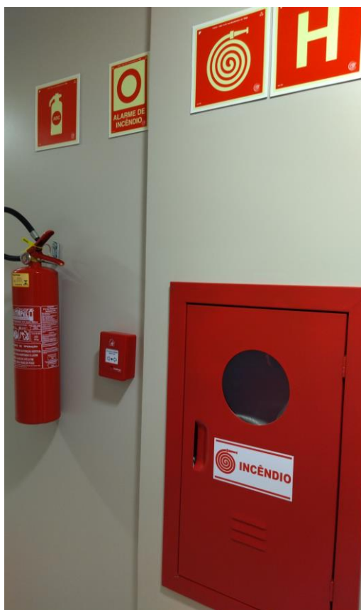
Figura 27 - Hidrante simples e componentes de combate a princípio de incêndio nos hall dos pavimentos tipo
