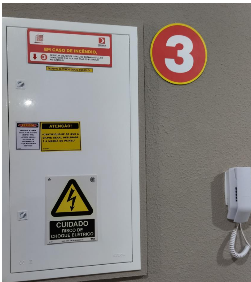
Figura 18 - Quadro elétrico geral do Subsolo
