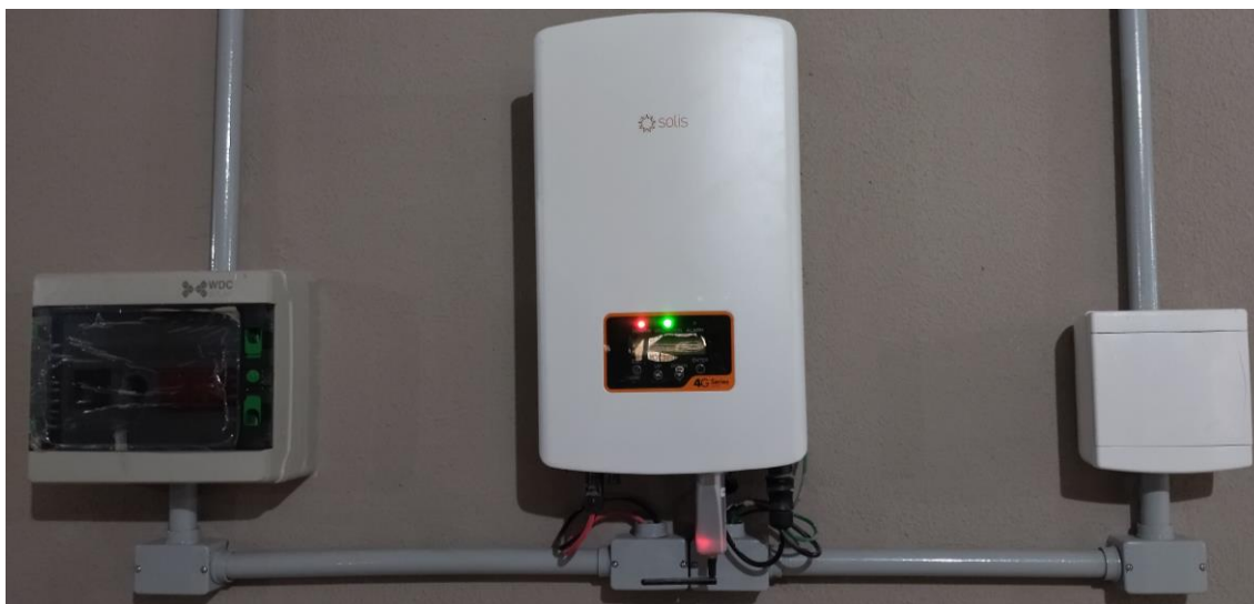
Figura 30 - Equipamento do sistema fotovoltaico no pavimento subsolo
